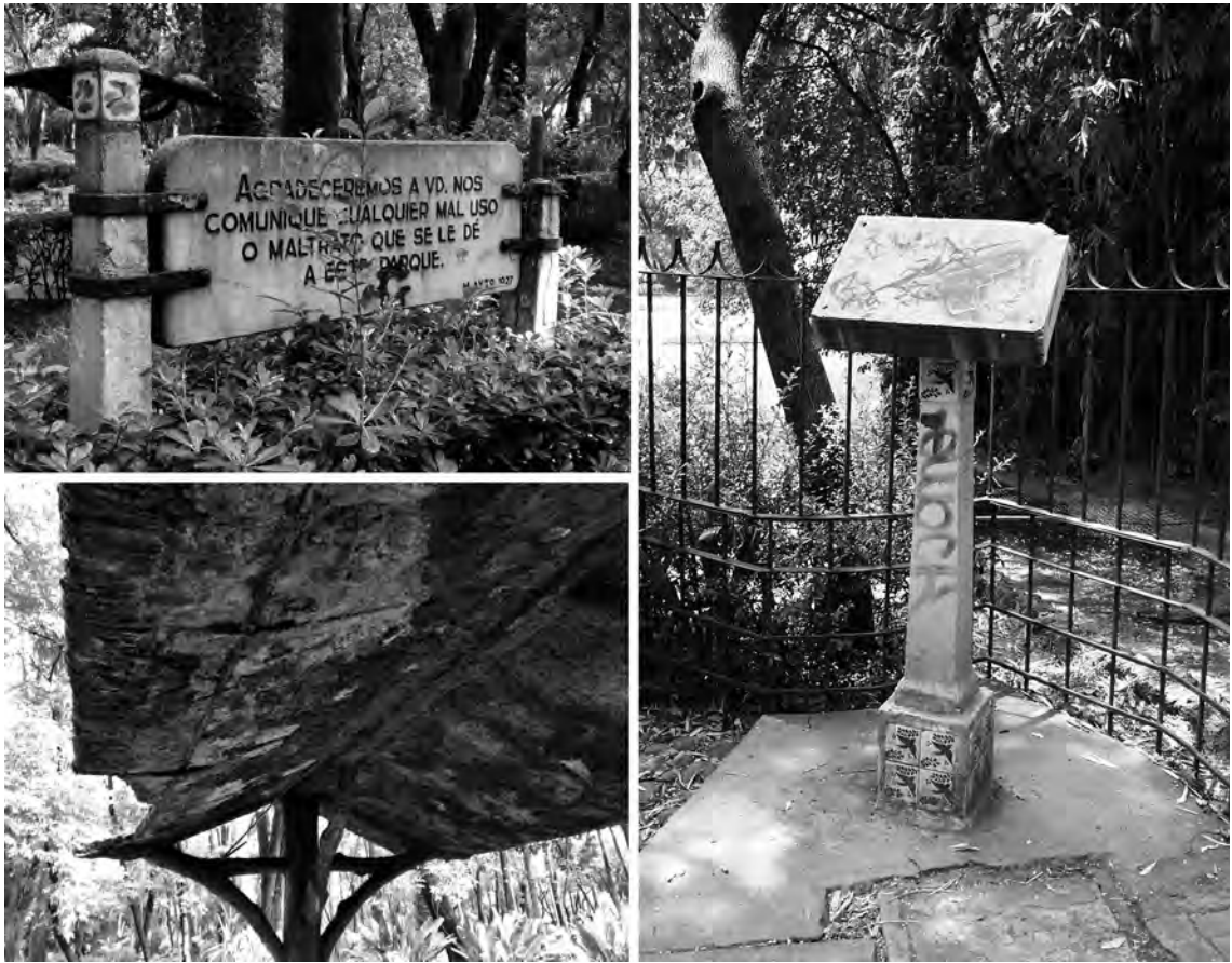
IMAGEN 11. Deterioros en el mobiliario art déco del Parque México. Fotografía: ssl, 2020.
