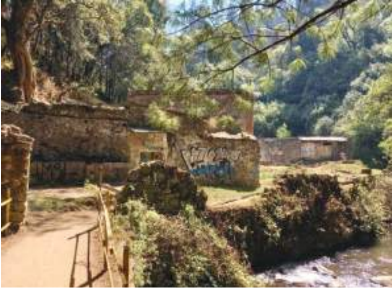
Figura:4 Fotografía actual en donde se aprecia muy deteriorado el tercer Dinamo
